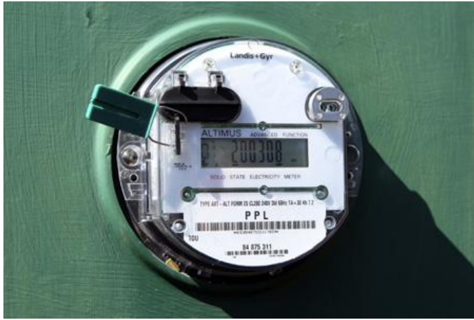
A Smart Meter
